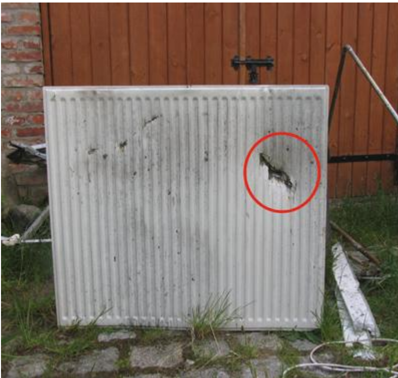
Bild 6: Der Heizkörper, der vom Kessel durchschlagen wurde.
